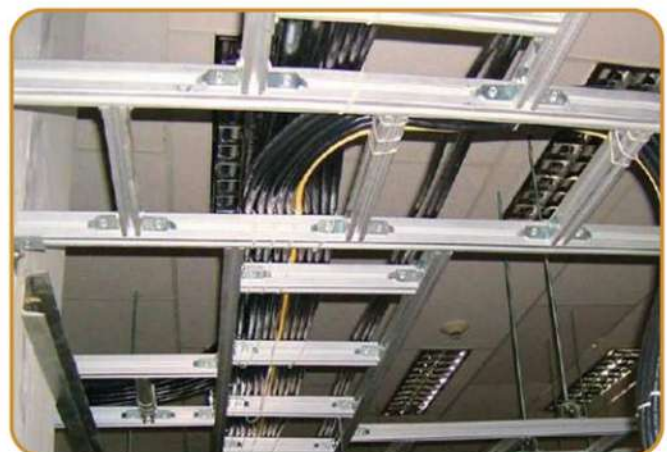
Cable / Cable Trays
